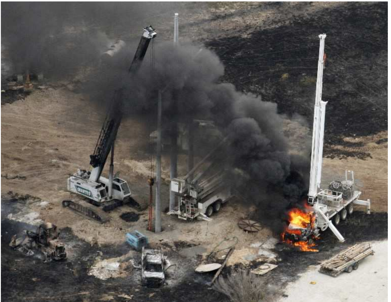
Photo : Explosion sur un chantier d'extraction. Marcellus shale
